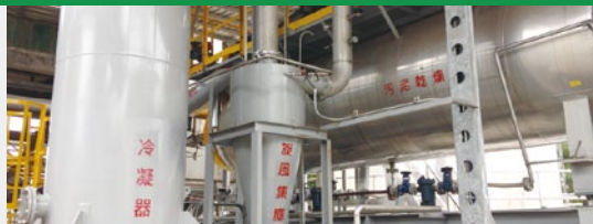
汙泥乾燥設備
