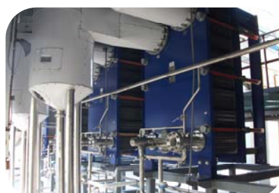
2號濃縮C系節能 (板式+TVR)設備
