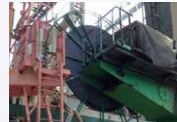
高壓電纜捲盤設備損壞
