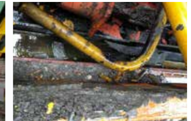
高壓電纜斷裂
