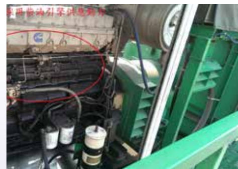
使用市電供應車機動力
