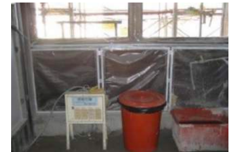
電箱、垃圾桶、沉澱池
