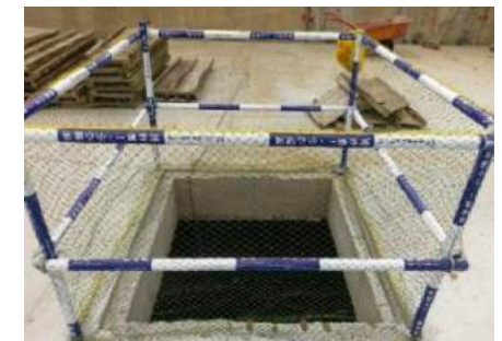
樓板開口固定式護欄及防墜網
