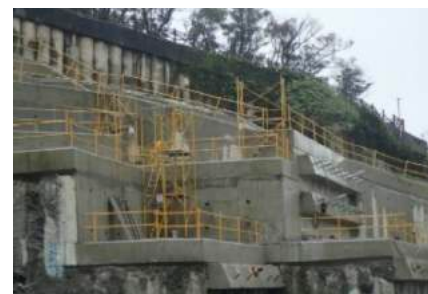
高處設有防墜設施
