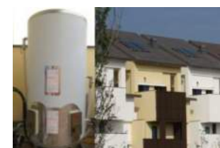
屋頂層裝設儲熱桶及太陽能集板
