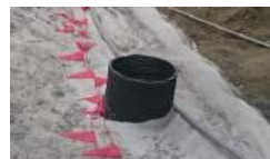
HDPE 滲透井收集雨水入儲水層。
