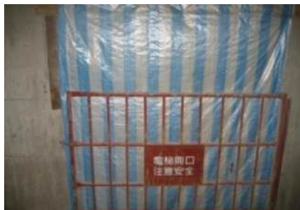
電梯開口防護
