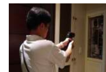
檢測總開關箱電源現況
