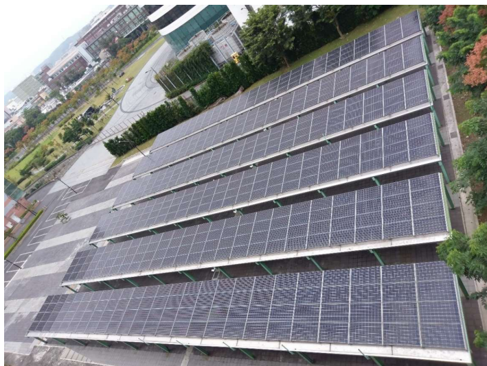
總公司及工廠太陽能光電發電系統
