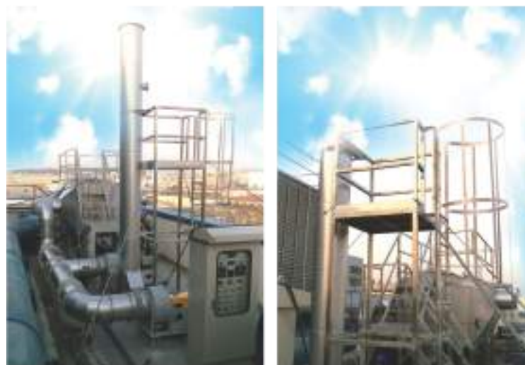
設置空氣污染防制設備處理VOCs，降低對環境之衝擊
