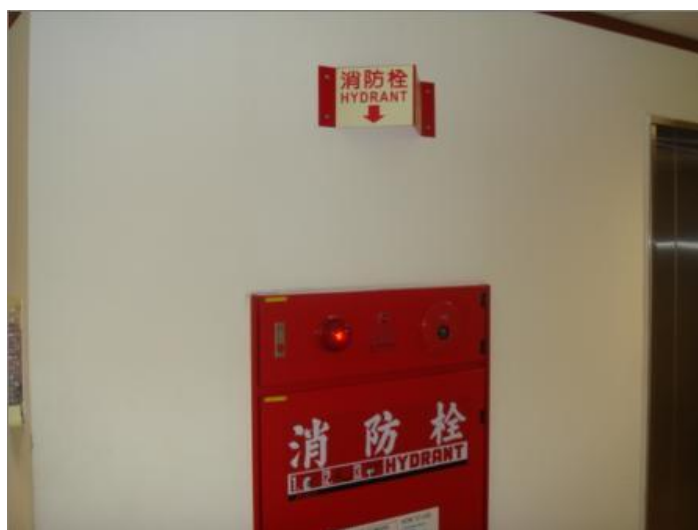
消防栓、箱增加立體標示
