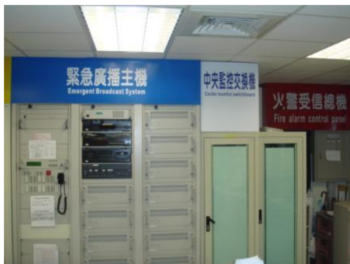
設置中央監控中心
