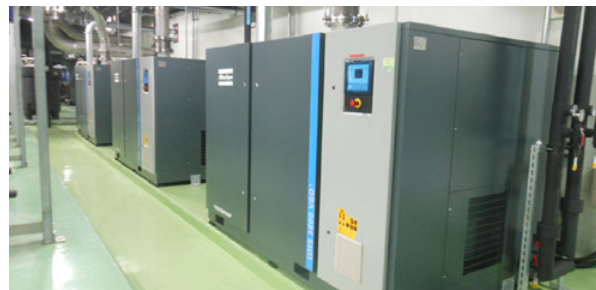
SPIL 中科廠 - 導入高效率真空機組
