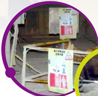
出入口做標 示人員管制
