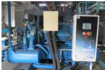
空壓機汰換提升效率
