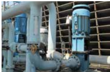
冷卻水循環泵變頻化
