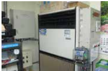
冷氣外掛變頻模組
