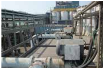
冷卻水塔風扇變頻化
