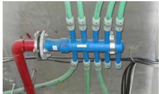
昇陽寓見樓板內管線採明管配置 (SI)
