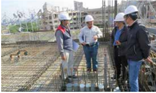
樓板灌漿前檢視缺失
