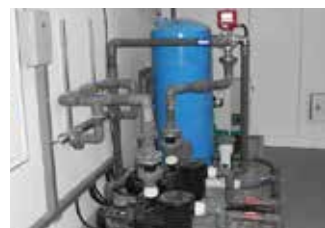
省水標章馬桶及雨水儲留設備
