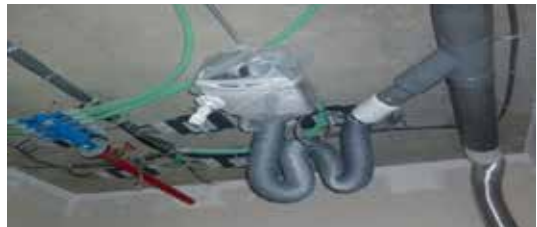
設置可定時自動開啟的排氣設備
