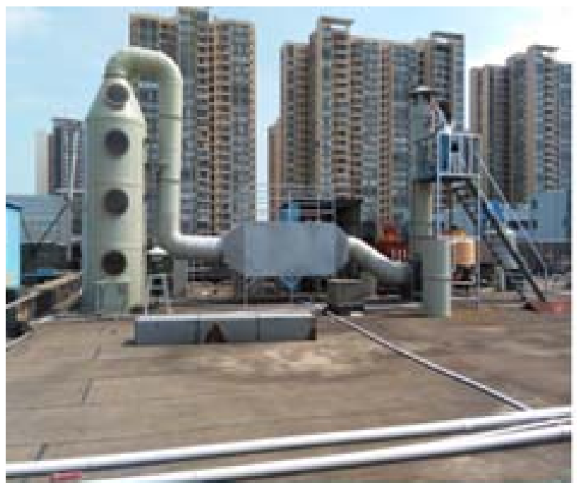
活性炭廢氣處理設施有效控制VOCs廢氣達標排放
