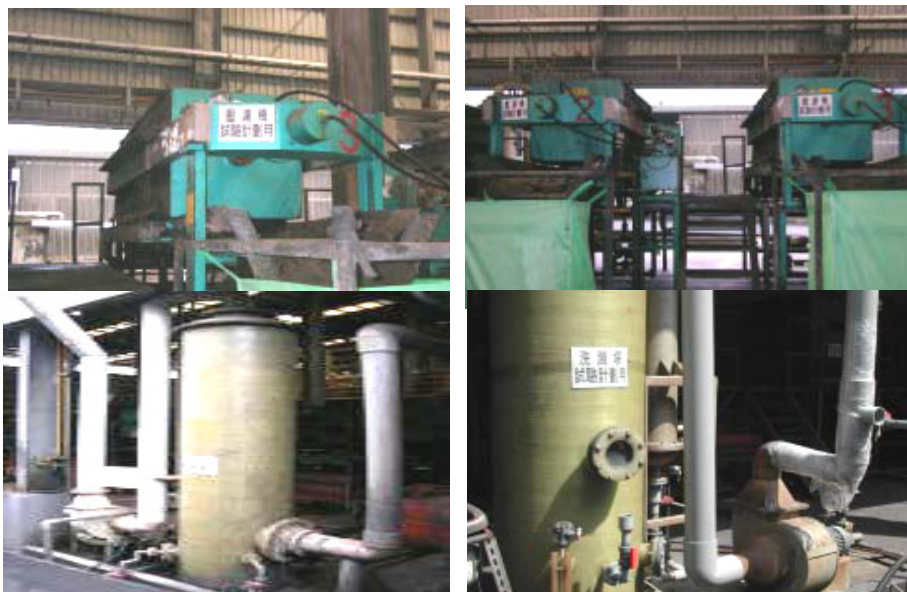
污水處理設備
