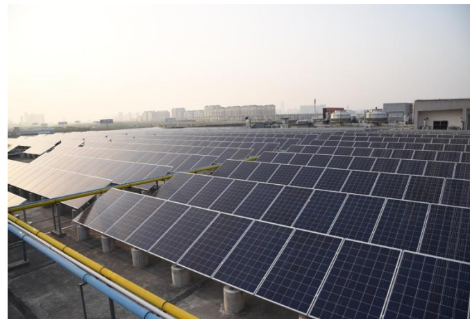
啟新廠屋頂太陽能發電站
