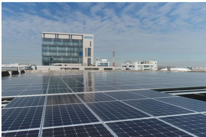
臺灣總部停車棟屋頂太陽能發電站
