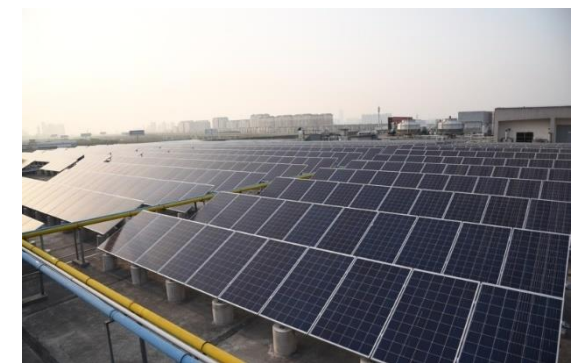
啟新廠屋頂太陽能發電站
