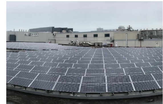
力行廠屋頂太陽能發電站
